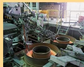
押出工程のコイル巻取機
